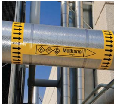
Marquage de tuyauteries
